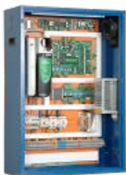
تابلو 3VF - EC16
