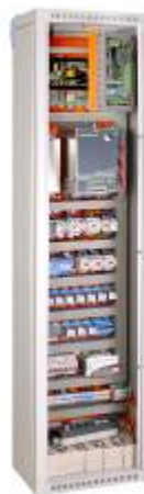
تابلو تلفیقی VVVF با درایو ZIEHL- ABEGG
