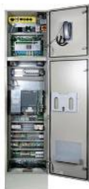
تابلو کنترل LISA
